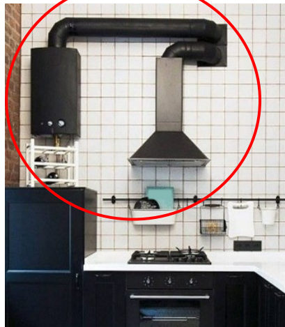
установка электромеханических вытяжек в помещении с установленным отопительным и водогрейным оборудованием с открытой камерой сгорания
